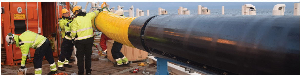
Figura 20. Cable eléctrico dinámico de alta tensión. (Fuente: NKT)
